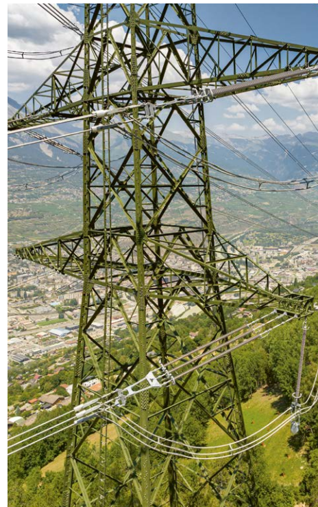
Un pylône tenseur
