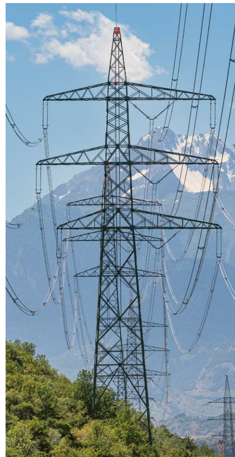
Un pylône porteur
